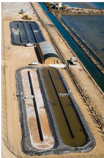
Figure I-11 : Bassins construits dans le cadre du projet Salinalgue à Gruissan (Aude, France)
